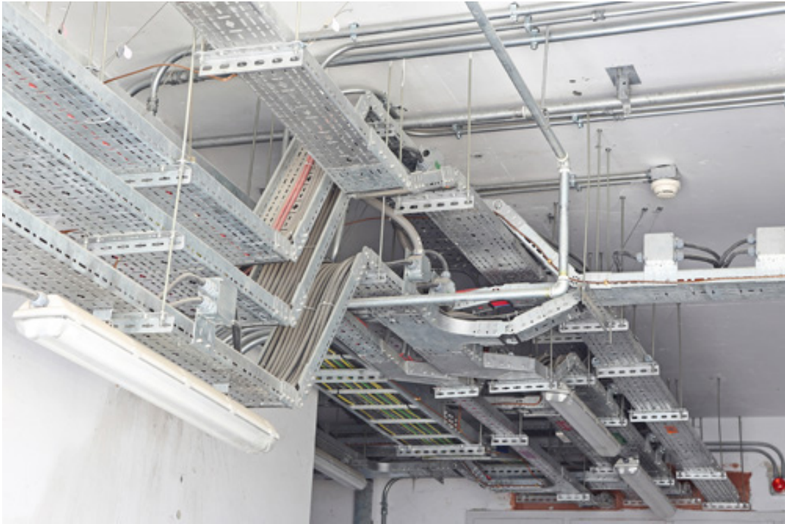
Fig. 3.2.21 Conduits and trays
